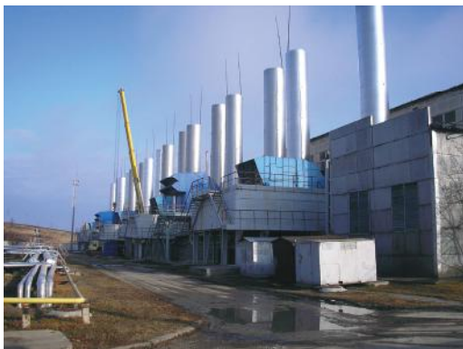
Рис. 1. Общий вид металлических дымовых труб турбоагрегатов КС «Заднепровская»
