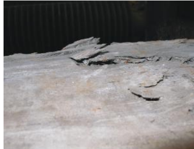
Рис. 3 Разрушение сжатой зоны бетона
