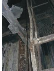
Рис.14. Деформация вертикальных элементов (подвесок) лифтовой шахты
