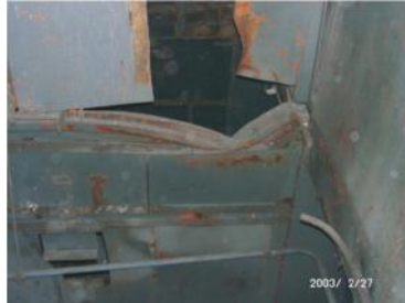
Рис.15. Повреждение балки на отметке -3,000м.
