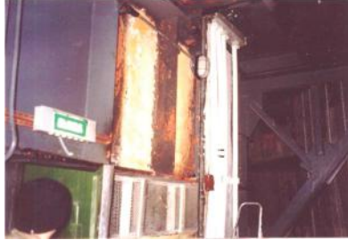
Рис.11. Разрушение защитного лакокрасочного слоя, выпучивание стенки второстепенной балки на отм. +153.0 м
