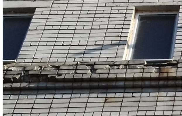
Рис. 3. Разрушение кирпичной кладки / The destruction of masonry
