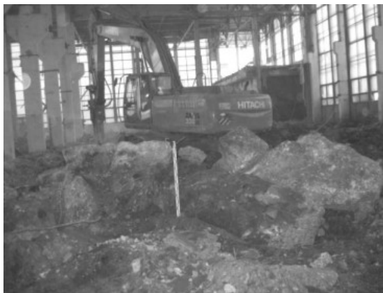
Рис. 1 Внутренняя реконструкция производственных зданий (демонтаж пола) / Internal reconstruction of industrial buildings (dismantling the floor)
