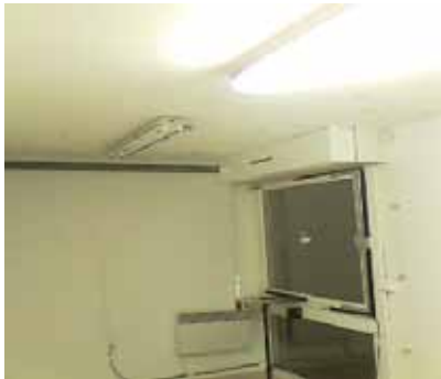
Caisson d'entrée d'air
