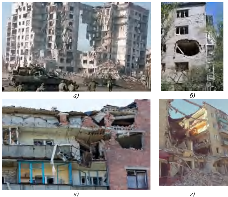
Рис. 3. Зруйновані або пошкоджені будівлі на сході України у містах: а – Луганську; б – Слов'янську; в – Краматорську; г – Миколаївці
