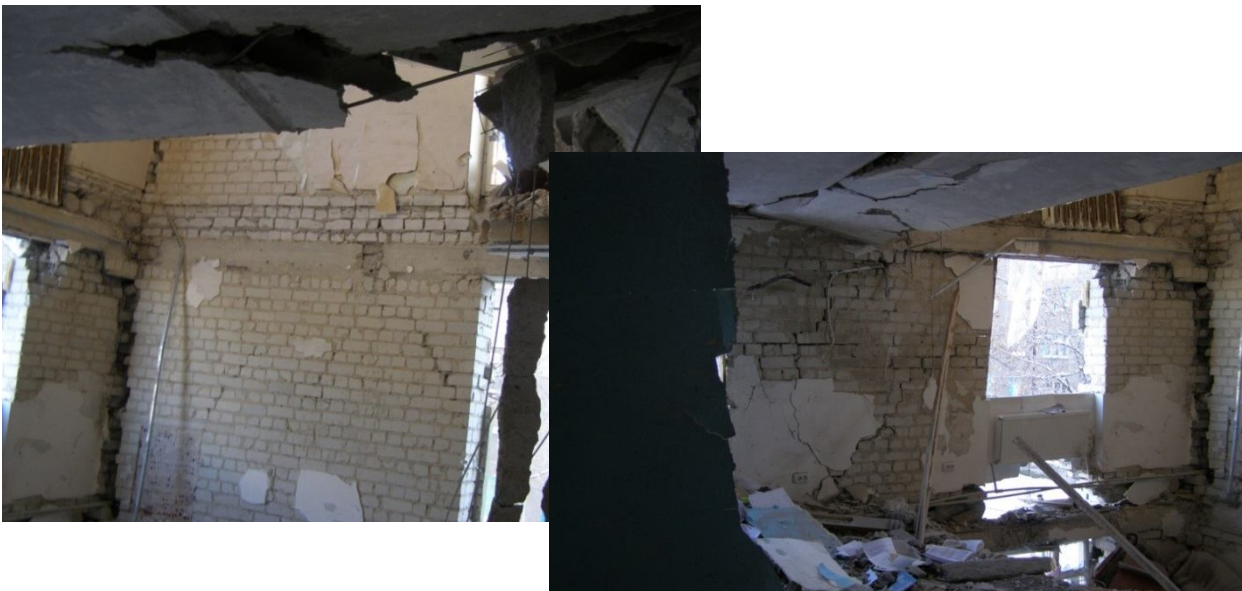
Рис. 6. Обрушены перекрытия в осях 4/1 — 5 между осями Б-Г над вторым и третьим этажом. Повреждены плиты в осях 4 - 4/1 между осями Б-Г над вторым и третьим этажом и в осях 4/1 — 5 между осями Б-Г над первым этажом / Failure in floor slabs in axes 4/1 — 5 between axes Б-Г above the second and the third floors. Damaged slabs in axes 4 - 4/1 between axes Б-Г above the second and the third floors and in axes 4/1 — 5 between axes Б-Г above the first floor.
