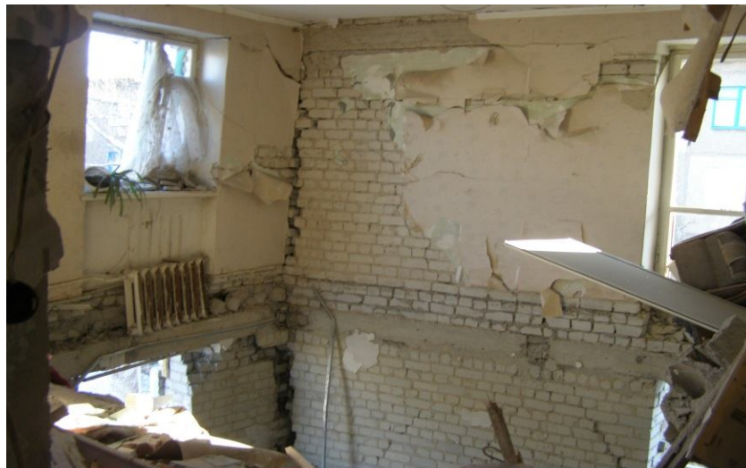
Рис 3. –Обрушены перекрытия в осях 4/1 — 5 между осями Б-Г над вторым и третьим этажом Трещины в углах здания шириной раскрытия до 150 мм. Разрушен защитный слой бетона и оголена арматура в междуэтажных монолитных поясах / Failure in floor slabs in axes 4/1 — 5 between axes Б-Г above the second and the third floors. Cracks in corners of the structure with crack propagation up to 150 mm. Damaged concrete cover and bared rebars in inserted monolithic floors
