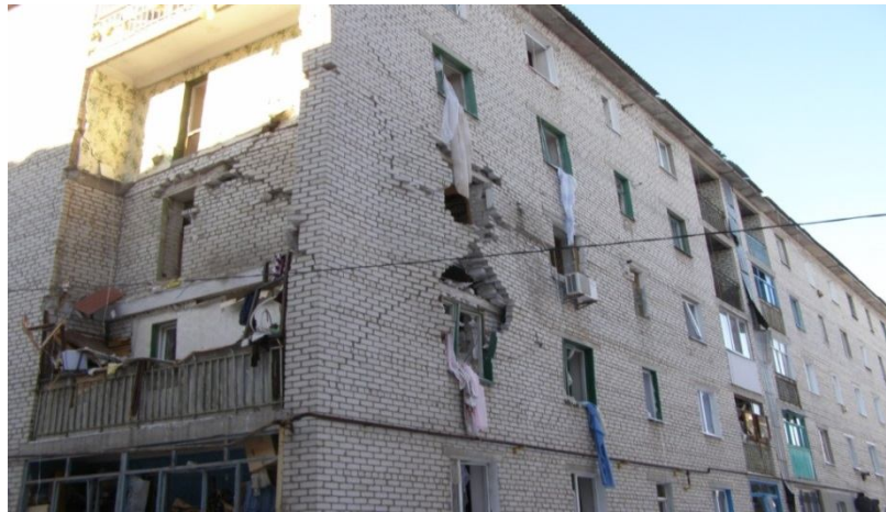
Рис 2 - Деформирована и разрушена кладка наружной несущей стены в осях 6-1 по оси Г блок секции №3 жилого дома №3а с образованием трещин с четвертого по второй этаж. Выбиты стекла в окнах блок секции №3 жилого дома №3а / Deformed and damaged brickwork in exterior bearing wall in axes 6-1 along axis Г block-section No.3 in residential building No.3a with crack formation from the fourth up to the second floor. Broken glass in windows of block-section No.3 in residential building No.3a
