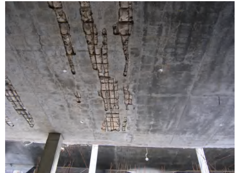
Рис. 6. Дефекты бетонирования, вызванные недостаточной водостойкостью пустотообразователей из картонных труб
