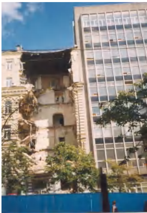
Рис. 1. Обрушение стены в результате проведения ремонтных работ
