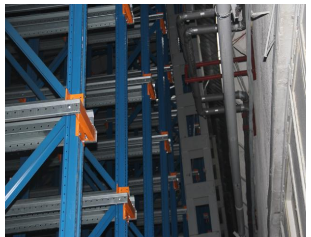
Рис. 5. Отклонение от вертикали колонн / Deviation from vertical columns
