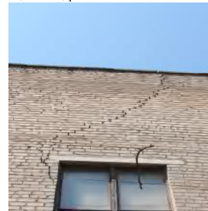
Рис. 3. Трещина в левом боковом фасаде здания Центр детского и юношеского творчества «Мрія» по ул. Мануильского г. Кривой Рог.
