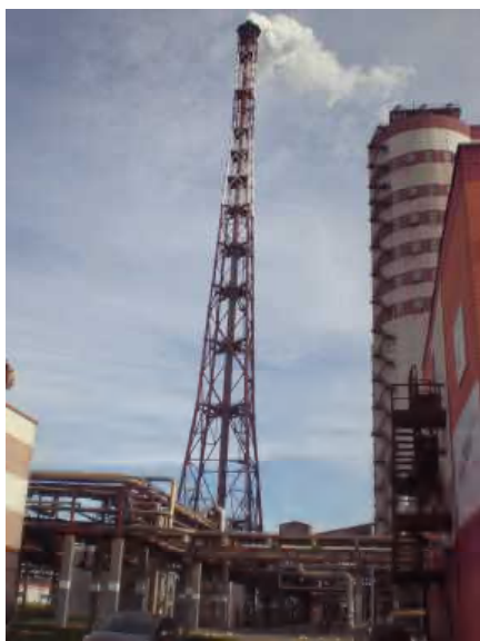
Рис2. Общий вид металлической башни высотой 180м цеха Аммиак ОАО «Акрон», г В.Новгород /
