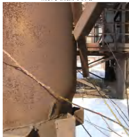
Рис 4. Потеря устойчивости ствола дымовой трубы/
