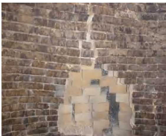
Рис. 6. Разрушение кладки футеровки и теплоизоляции трубы /
