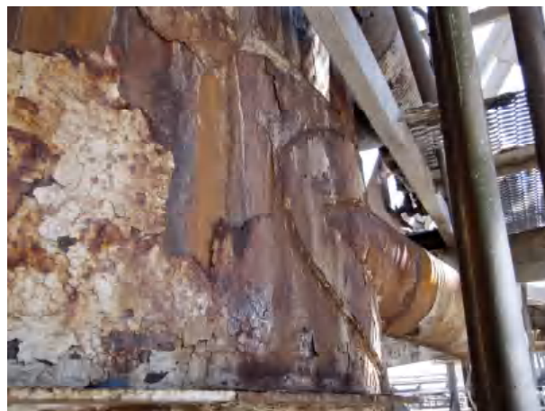
Рис 3. Коррозионный износ дымовой трубы факельной установки более 10%/
