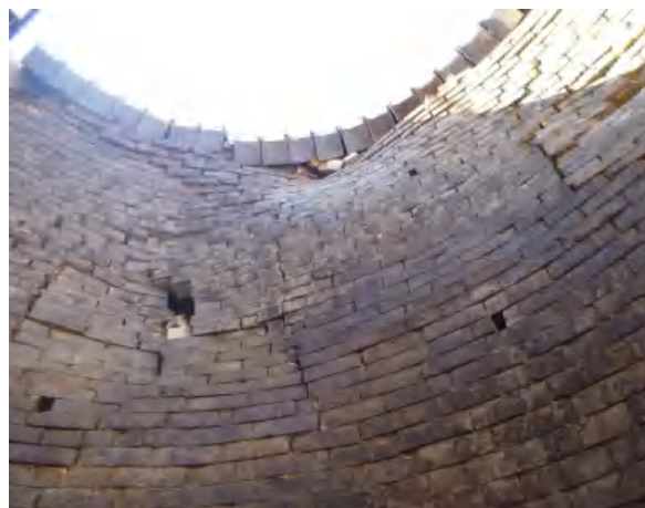
Рис. 7. Выпучивание (потеря устойчивости) кладки футеровки дымовой трубы /
