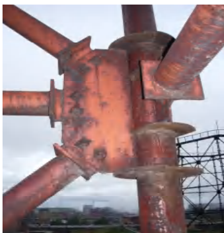
Рис 9. Коррозионный износ элементов несущей башни до 10%/
