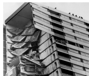
Рис. 1. Пошкодження житлового будинку «Ronan Point». 16 травня 1968р.
